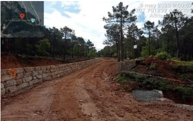
Trabajos de coordinación de Seguridad y Salud en recuperación infraestructuras prevención incendios daños DANA
